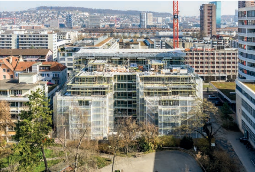
Blick auf die Baustelle an der Badenerstrasse 423–431 zwischen Heiligfeldpark und Badenerstrasse. Rechts der Turmzylinder des Schlotterbeck-Areals. (Peter Knup)
